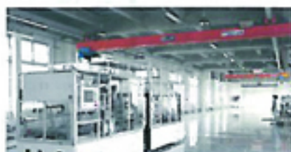
パネル製造機器の設置工事を進める工場内。8月末には設備で埋め尽くされる
