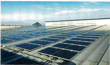
オリックスは蓄電設備併設型のオンサイトPPAの実績を持つ。写真はその設置事例の一つで、「スーパーマーケットパロ〜ゆいの里店」に設置された太陽光パネル
